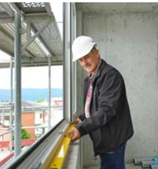
Kontrolle ist wichtig: Hans Blattmann macht eine Stichprobe und prüft, ob die Fenster gerade montiert wurden.
